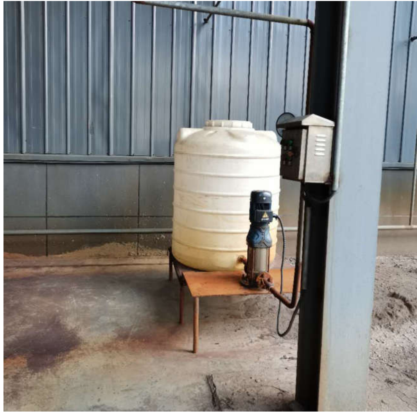
图 4.1-8 煅烧车间炉内烟气脱硝用的尿素（共四个）
