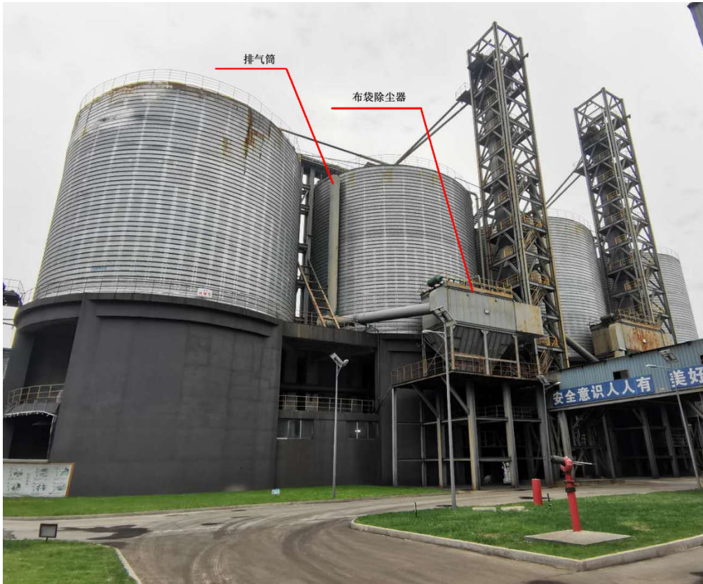
图 4.1-6 破钢板筒仓除尘器 and 排气筒
