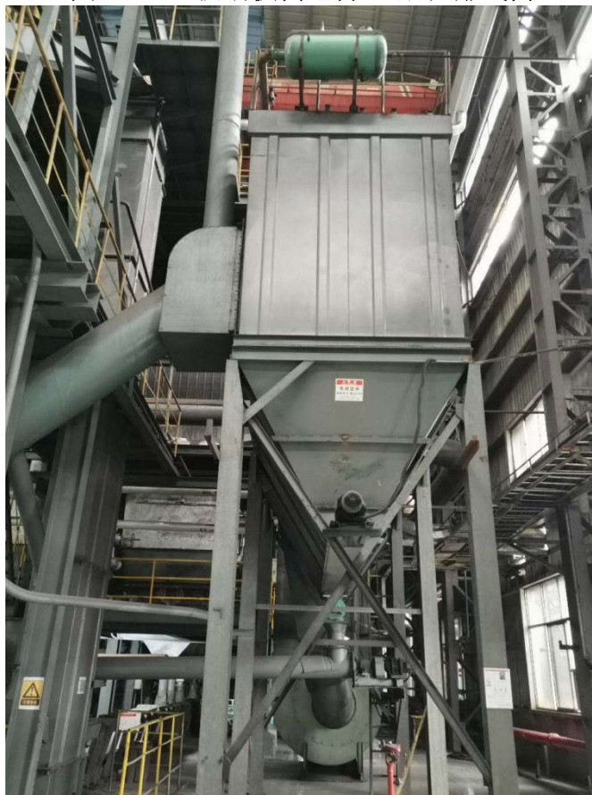
图 4.1-7 煅烧车间下料工段布袋除尘器 (共四个)
