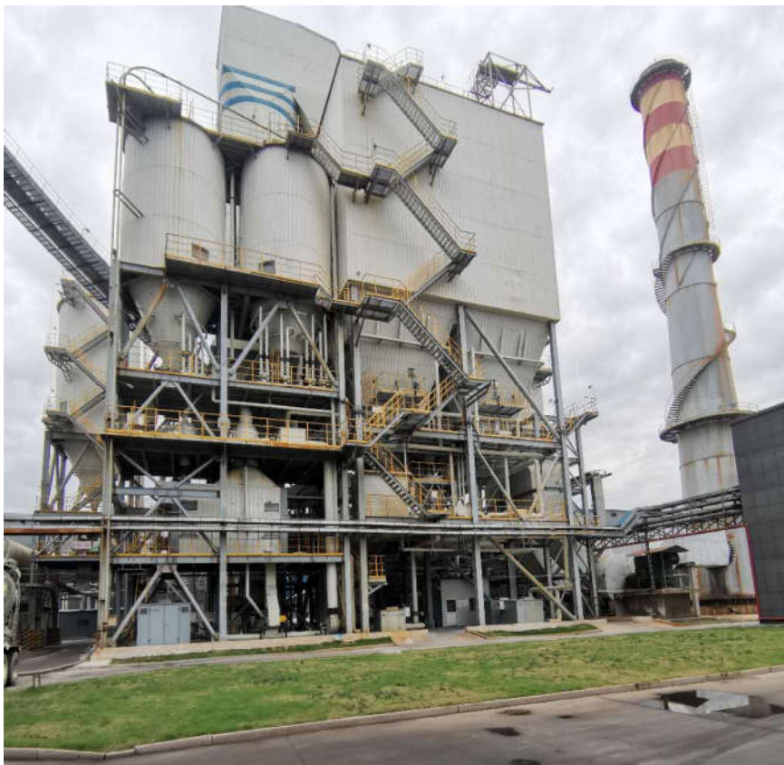
图 4.1-9 煅烧车间燃烧废气脱硫除尘措施和排气筒
